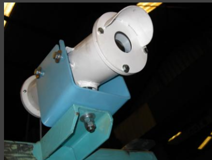
Cámara de CCTV en Punzonadora
